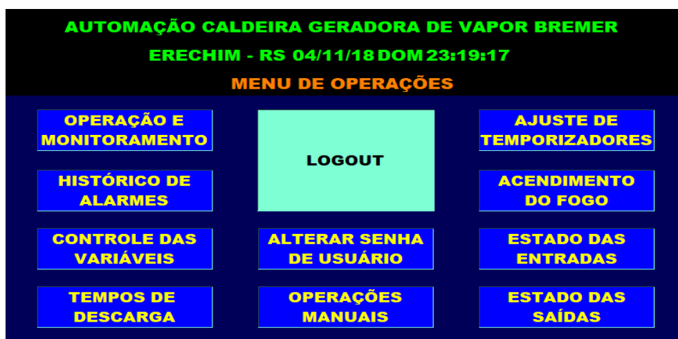
Figura 2 – Tela de menu do sistema supervisório da caldeira
