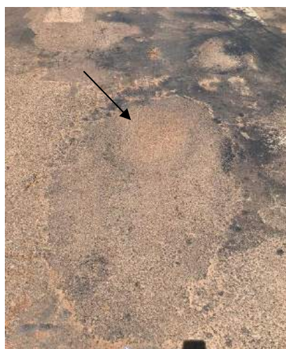
Figura 7 - Afundamento no reparo 1.
