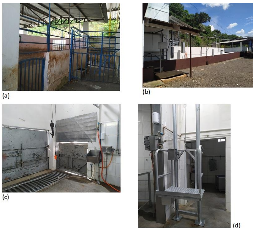
Figura 2 - Ambientes do abatedouro que se encontram em não conformidade: (a) corredores dos animais na forma de labirinto; (b) corredor com muro que não atende a altura; (c) porta a esquerda em posição imprópria; (d) elevador sem proteção inferior.
