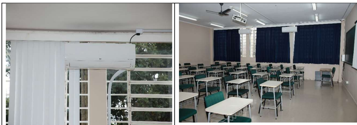
Figura 34: Ar condicionado instalado nas salas de aula do prédio 12
