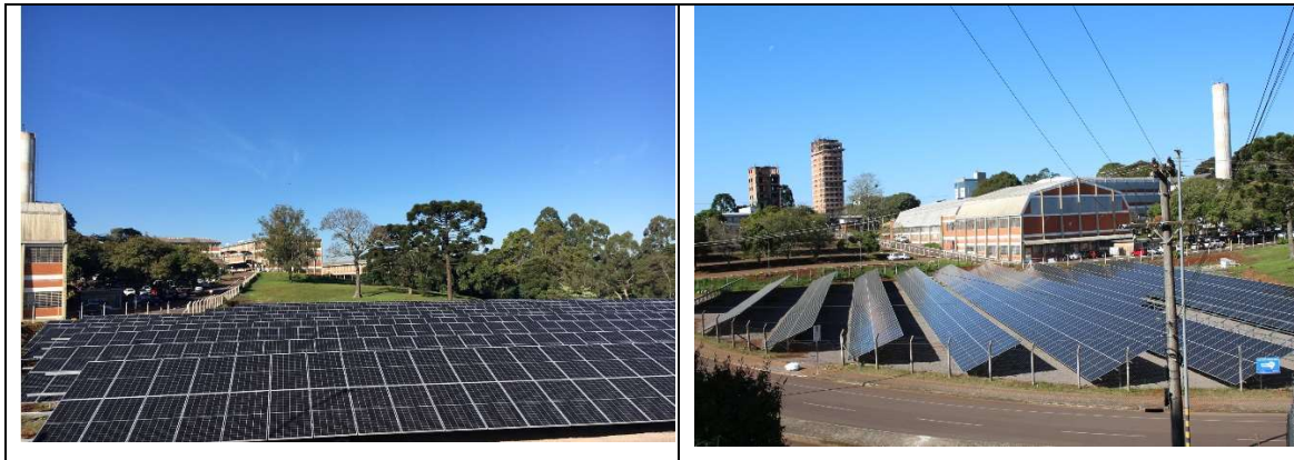
Figura 32: Usina Fotovoltaica instalada no Câmpus I
