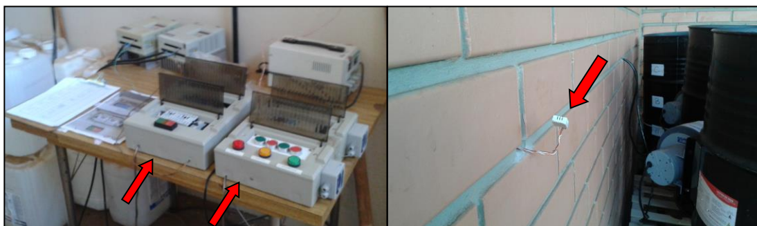
Figura 10 - Quadro de sistema de automação (1) e de controle do sistema manual (2), e o Sensor de temperatura e de umidade relativa do ar atmosférico (DHT22).
